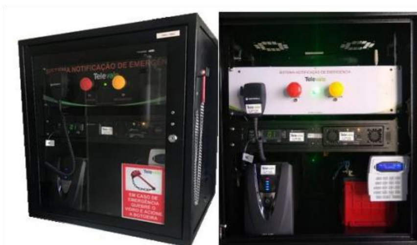
Figura 14 Central de Operação Local - COL
