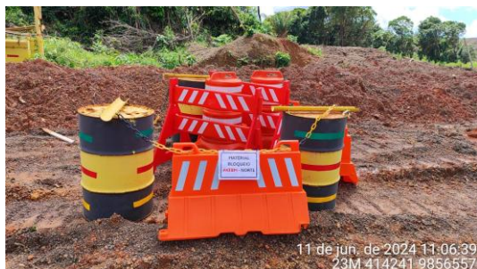
Figura 21 Material para bloqueio localizado na portaria P4
