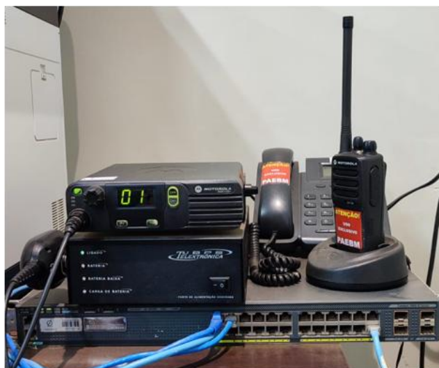
Figura 19 Rádio fixo, móvel e ramal da Sala de Crise
