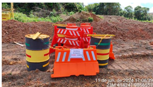
Figura 23 Material para bloqueio localizado na portaria P4
